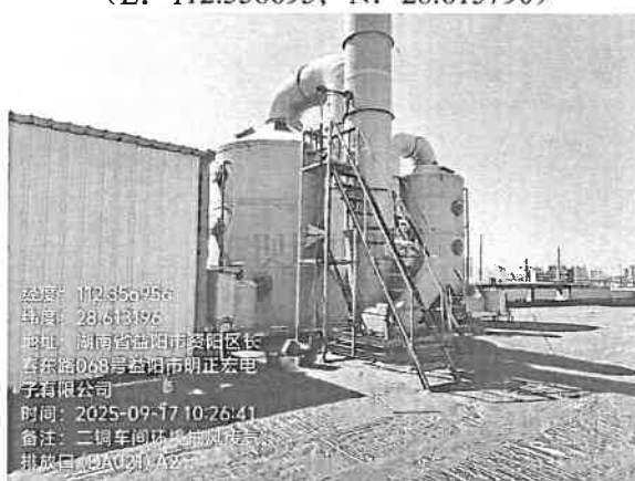
A 2 二铜车间环境抽风排放口 (DA021) (E: 112.356956; N: 28.613196)
